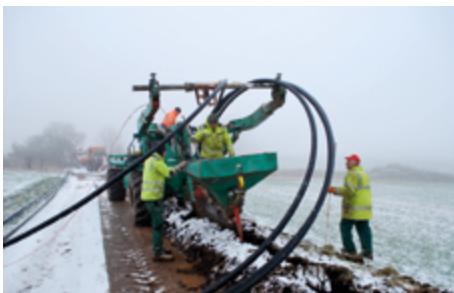
Das Kabelsystem verläuft entlang bestehender Wege.
